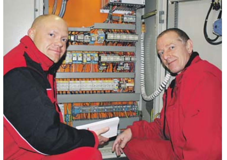
Die beiden Haustechniker Jan Redieske und Gert Pörner in einer der acht Center-Technikzentralen auf dem Dach.
